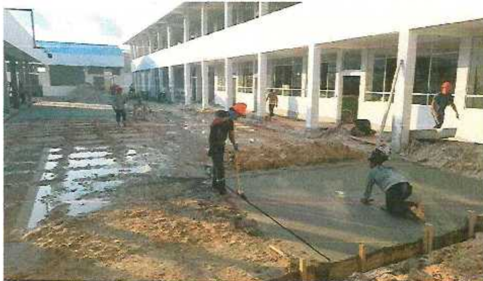
BRUÑADO – PATIO FORMACION
